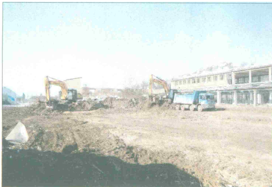
Uništeni objekti i napravljena deponija
